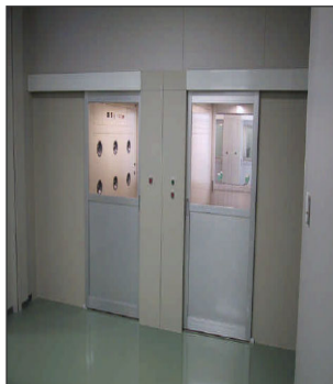
그림 13. 에워샤워기와 패스룸을 병렬설치한 예
