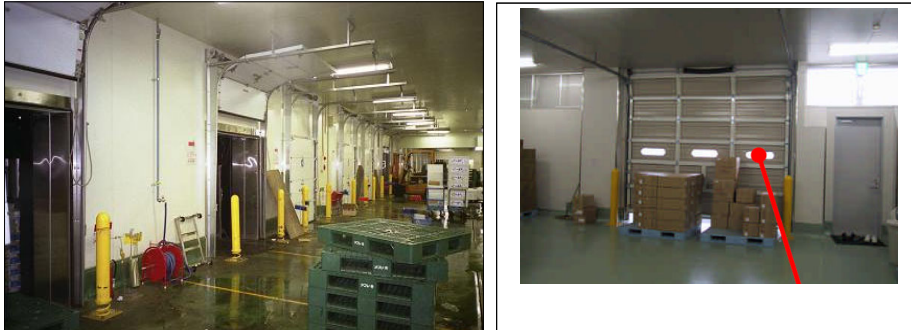
그림 48. 출하전실 dock shelter내측의 오버헤드도어
