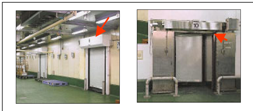
그림 108. 에어키퍼가 설치된 냉동·냉장창고의 방열문
