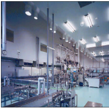
그림 136. 청결작업구역의 내부 배관
