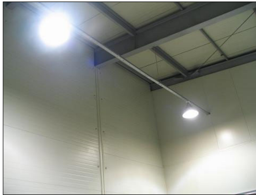
그림 172. 메탈할로겐등 설치 예
