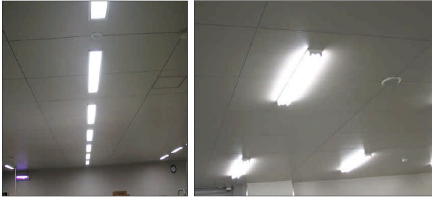
그림 168. 비산방지 커버를 설치한 조명
