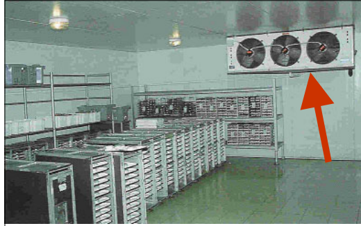
그림 158. 기내식 제조공장의 Unit cooler 설치 예
